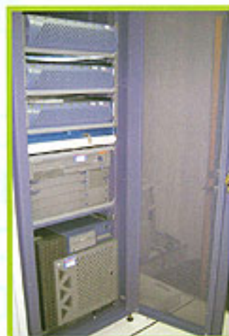
SERVER 主機 SUN SERVER
