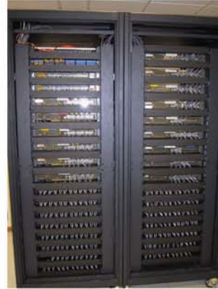
垂直線槽配線實例
