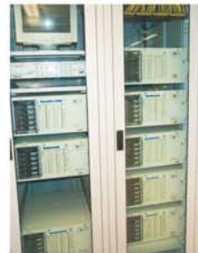
SERVER主機 HP SERVER
